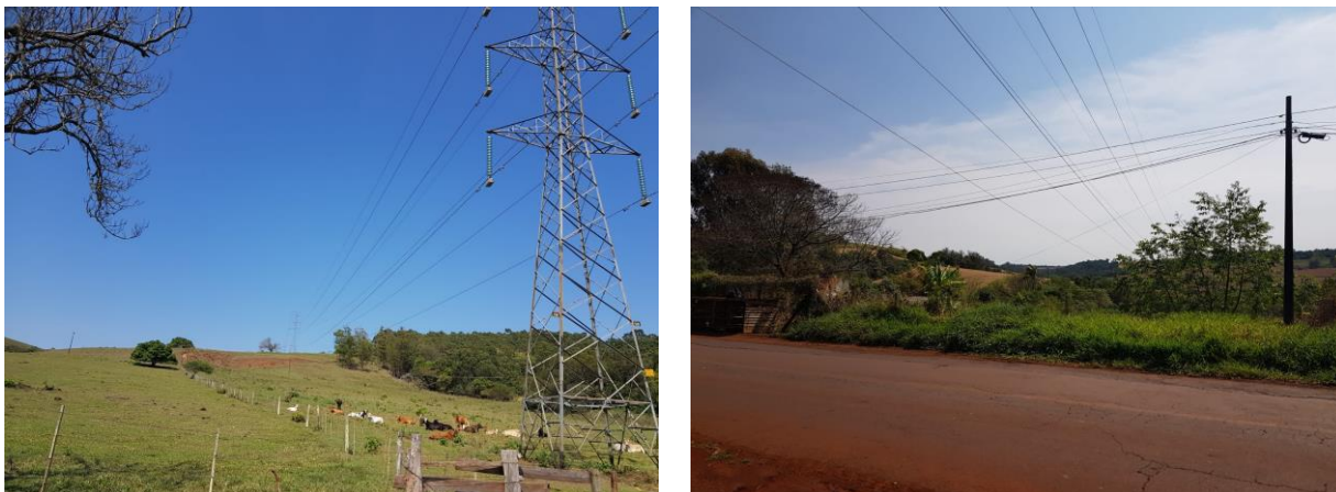
Figura 31 – Linha de transmissão de energia na AEU-DS
