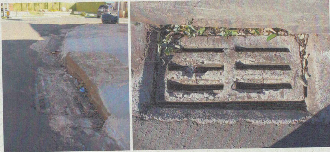
Foto 08: Bocas de lobo encontradas na Rua Hugo Simas, esquina com Fernando de Noronha, próximo ao local do empreendimento.
