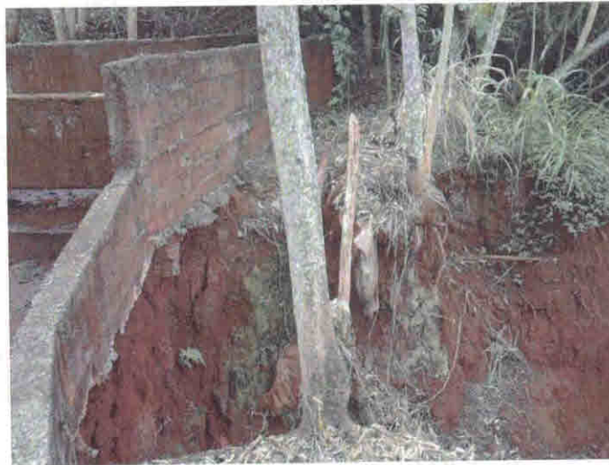
Figura 32: Vista da erosão no dissipador do Córrego Gabiroba (Julho de 2010).
