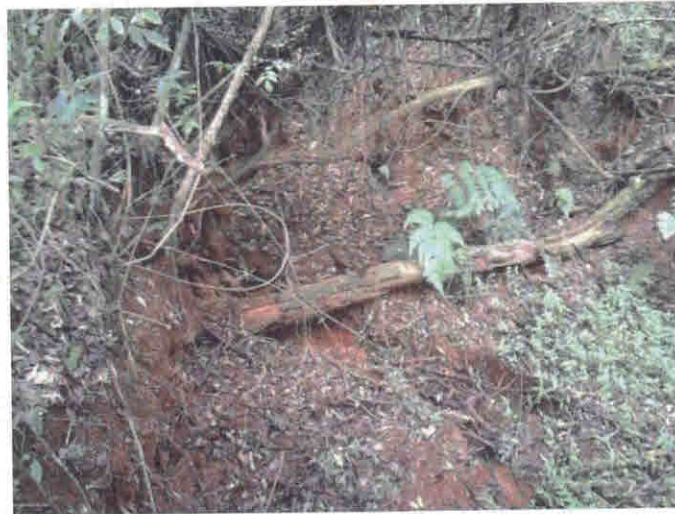
Figura 30: Uma das nascentes do Córrego Gabiroba, impactada pela erosão (Julho de 2010).
