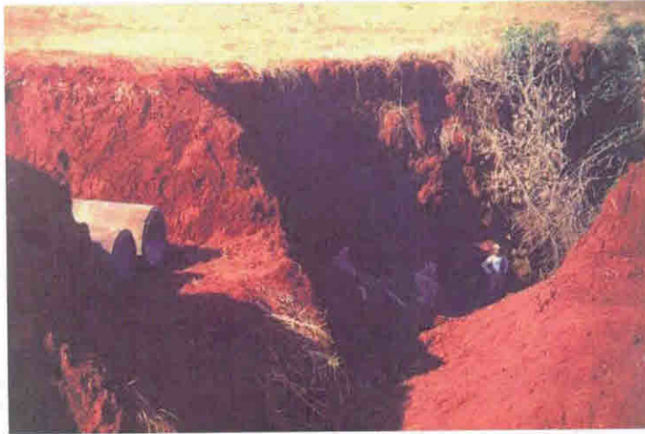
Figura 26: Erosão que se inicia na UEL e vai em direção ao córrego Gabiroba, que existia no local e foi reparada pelo empreendedor
