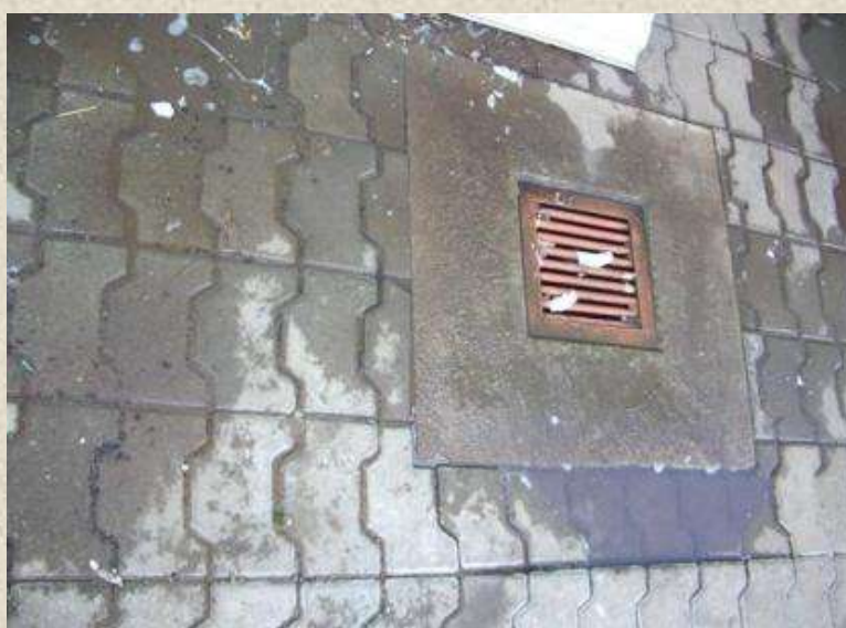
Figura 38: Saída para águas pluviais com contaminação por lavagem.
