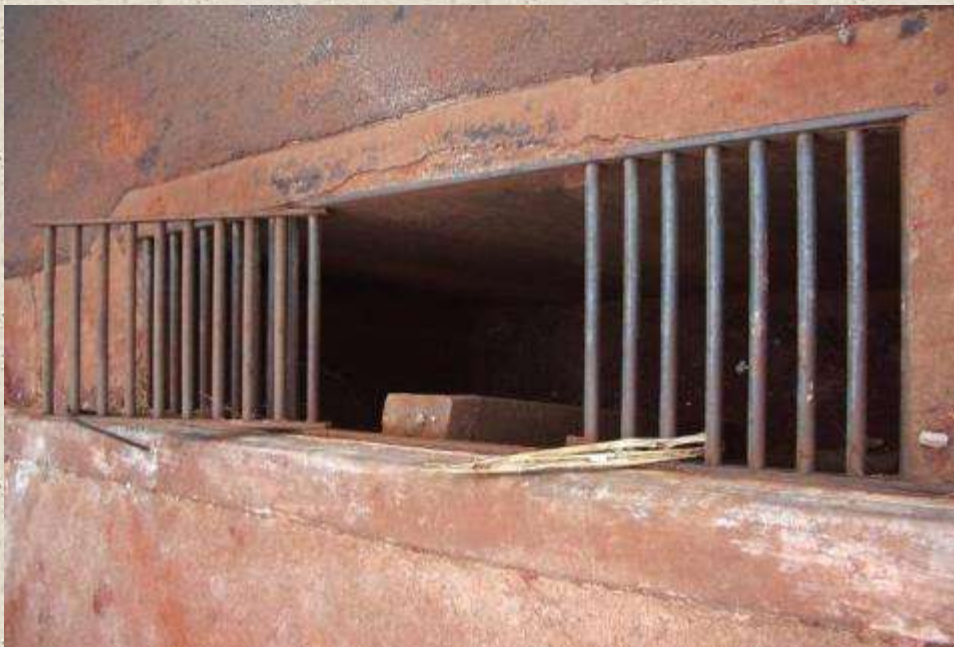
Figura 16: Primeiro bueiro, para onde drenam as águas do terreno.
