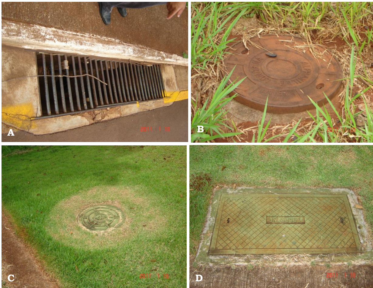
Figura 08: Equipamentos públicos existentes no local
