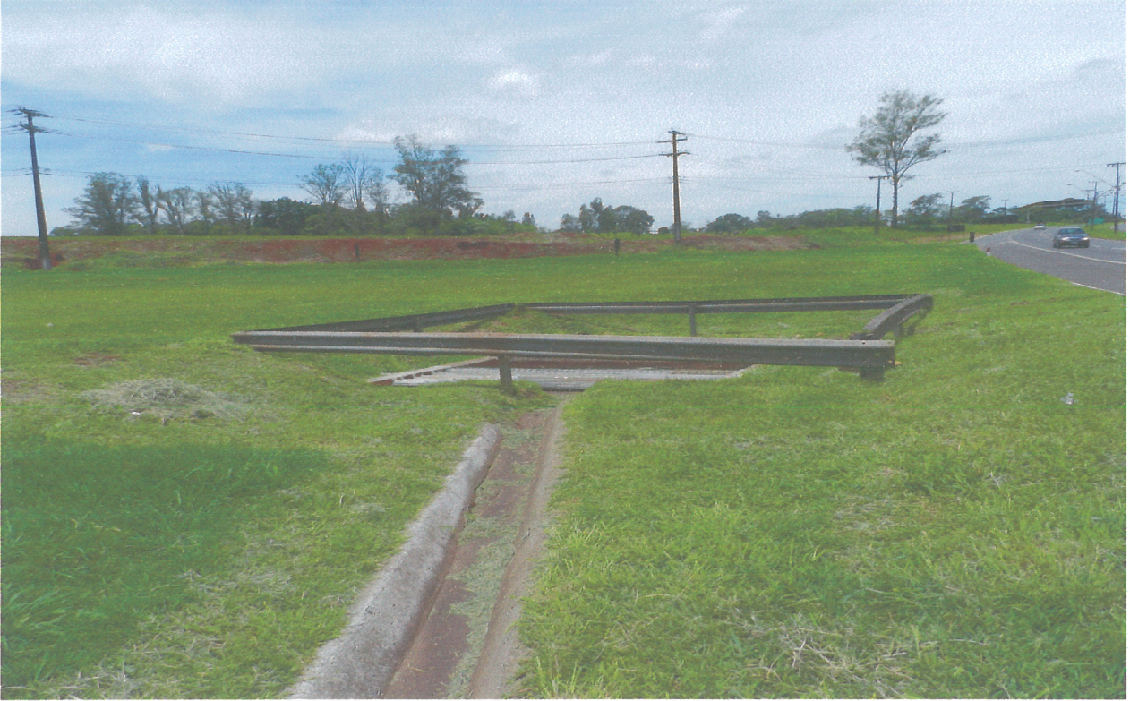
Foto 08: Sistema de drenagem BR369.
