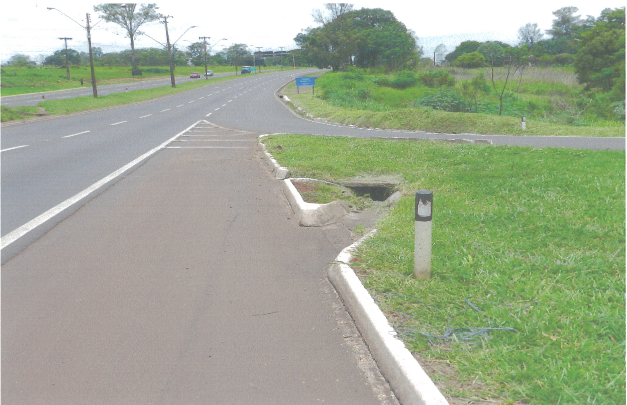
Foto 09: Sistema de drenagem Rodovia 369.
