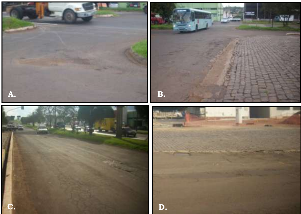
Figura 21: Más condições da pavimentação das vias de acesso.
