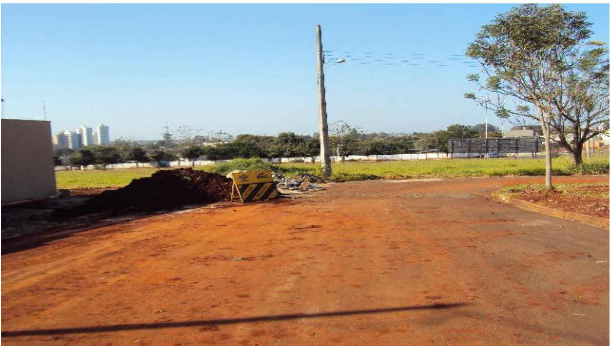
Foto 22: Exemplo de emissão de particulados por obras de escavações.
