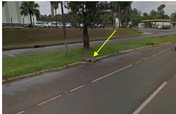
Figura 28: Vista de bueiro instalado na Avenida Tiradentes
