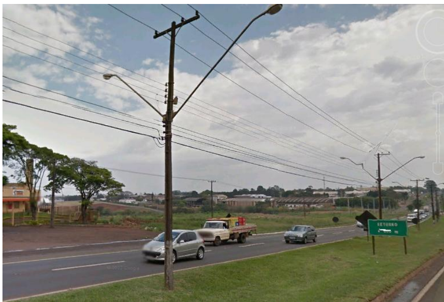
Figura 29: Vista das instalações da iluminação pública na Avenida Tiradentes.
