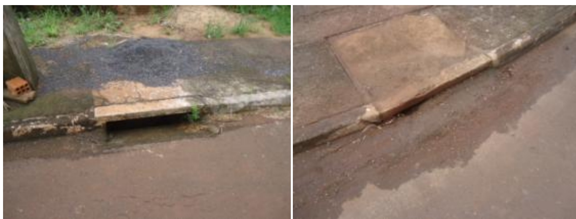
Figura 22: Bocas de lobo existentes na Rua Francisco Salton e José Roque Salton, no entorno do Escritório Bar, em Londrina PR, respectivamente Fonte: Master Ambiental (2013).
