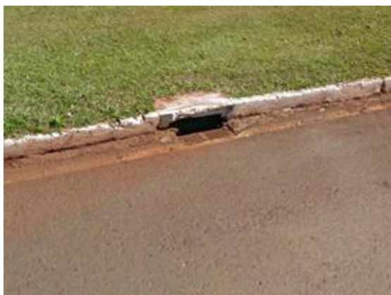
Figura 20: Vista de bueiro instalado nas proximidades do empreendimento, a Avenida Adhemar Pereira de Barros.
