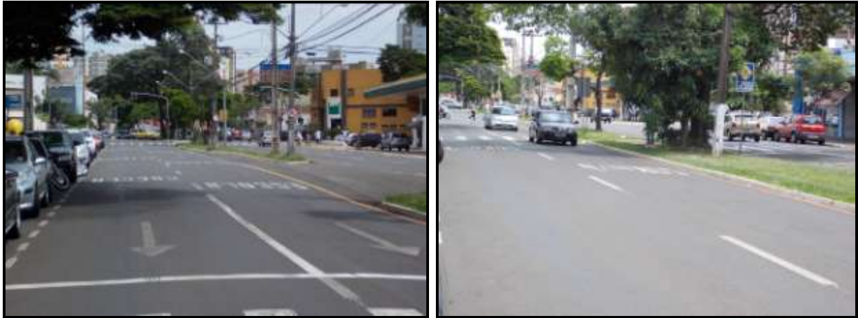
Figura 21: Estado de conservação da Avenida Duque de Caxias. Fotos: Brasil Ambiental, 2013.
