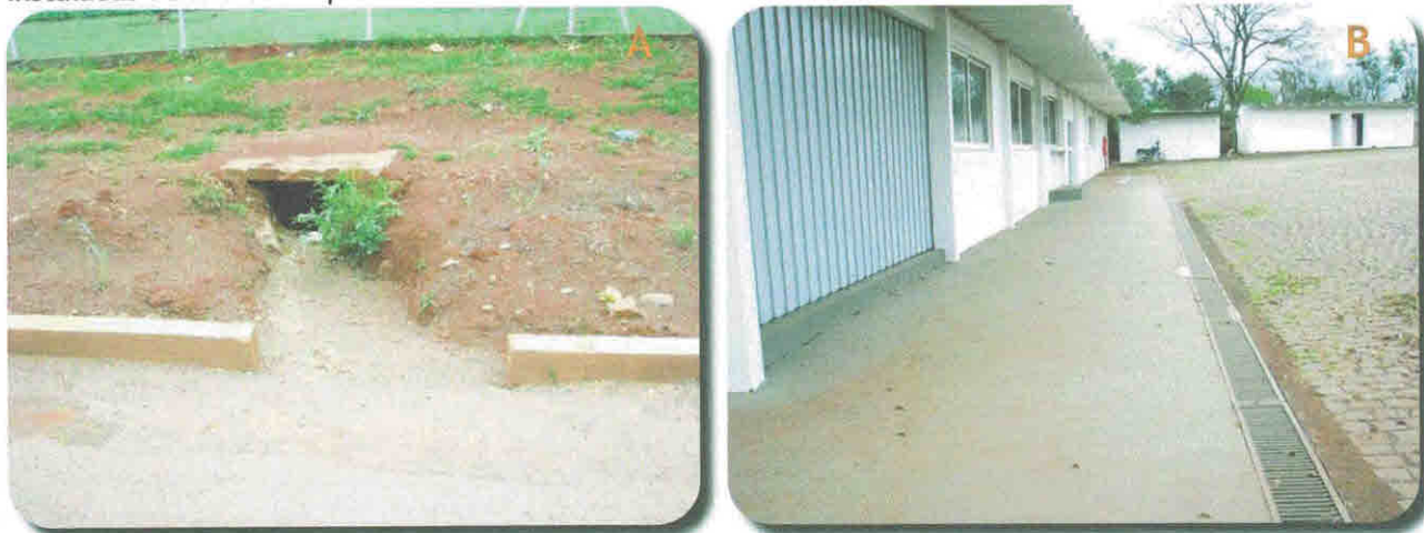
Figura 4.1. A) Galeria de águas pluviais externa ao empreendimento; B) Canaletas de águas pluviais instaladas dentro do empreendimento.
