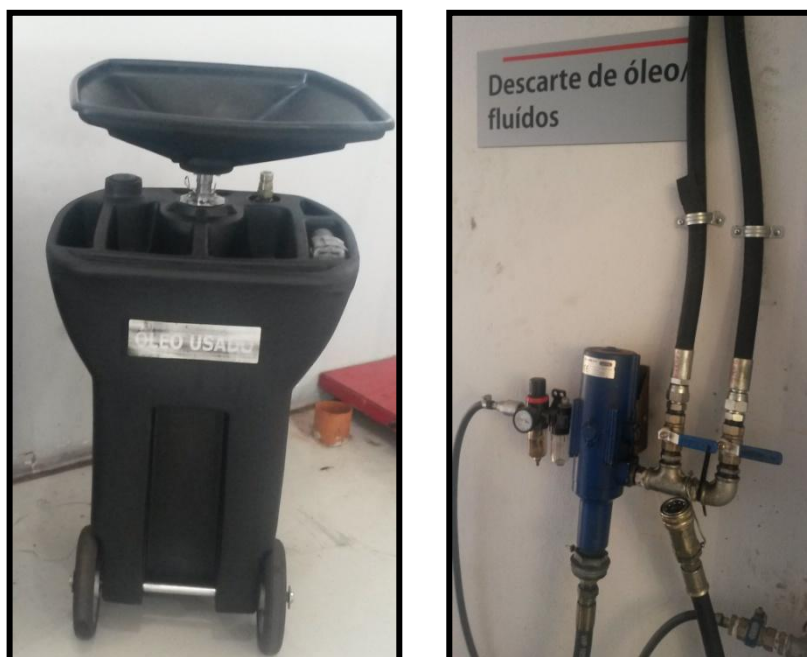
Figura 05: Instrumentos de coleta e bomba de envio de óleo para armazenamento.
