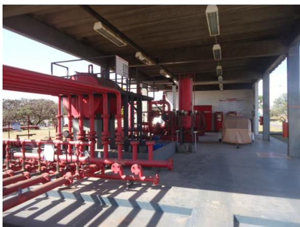
Figura 5. Sistema de combate a incêndio instalado no empreendimento.
