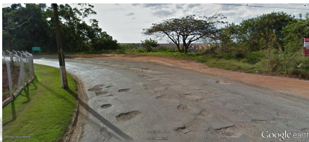
Figura 39. Buracos na Rua Graciliano Ramos, principal ponto de acesso aos empreendimentos industriais da região.
