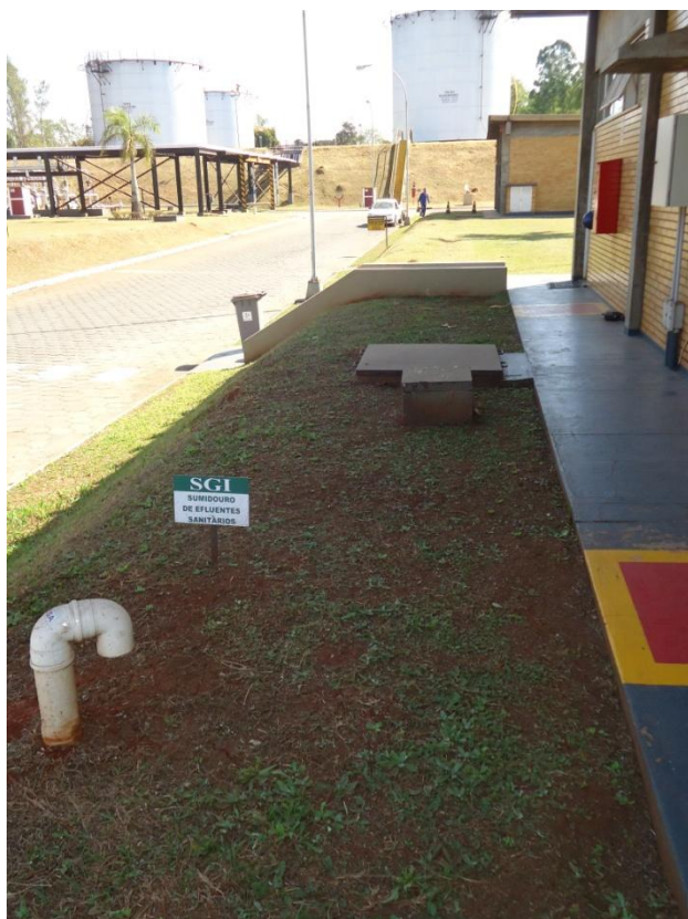
Figura 16. Sistema de tratamento de efluentes sanitários.
