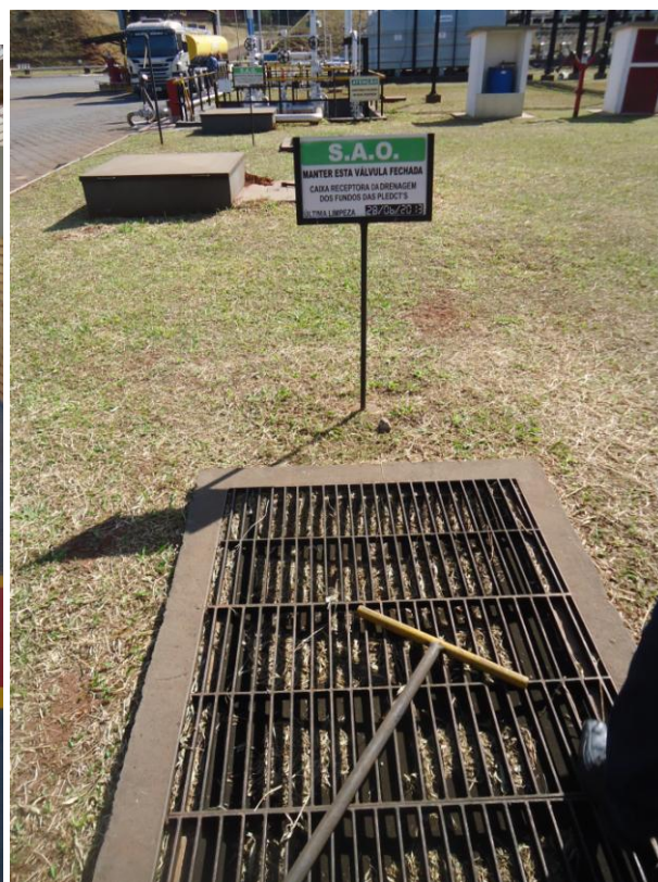
Figura 17. Sistema de tratamento de efluentes oleosos.
