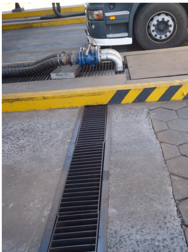
Figura 15. Sistema de captação de drenagem oleosa, a qual é encaminhada para sistema de tratamento específico.
