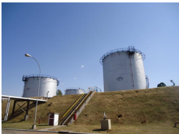
Figura 3. Vista dos tanques instalados na bacia de contenção.
