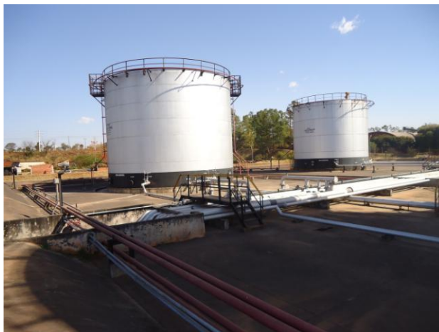
Figura 13. Bacia de contenção em torno dos tanques instalados.
