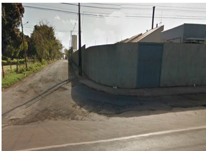
Figura 18: Irregularidades no pavimento asfáltico verificadas no cruzamento da Rua Primo Campana com a Avenida Tiradentes.
