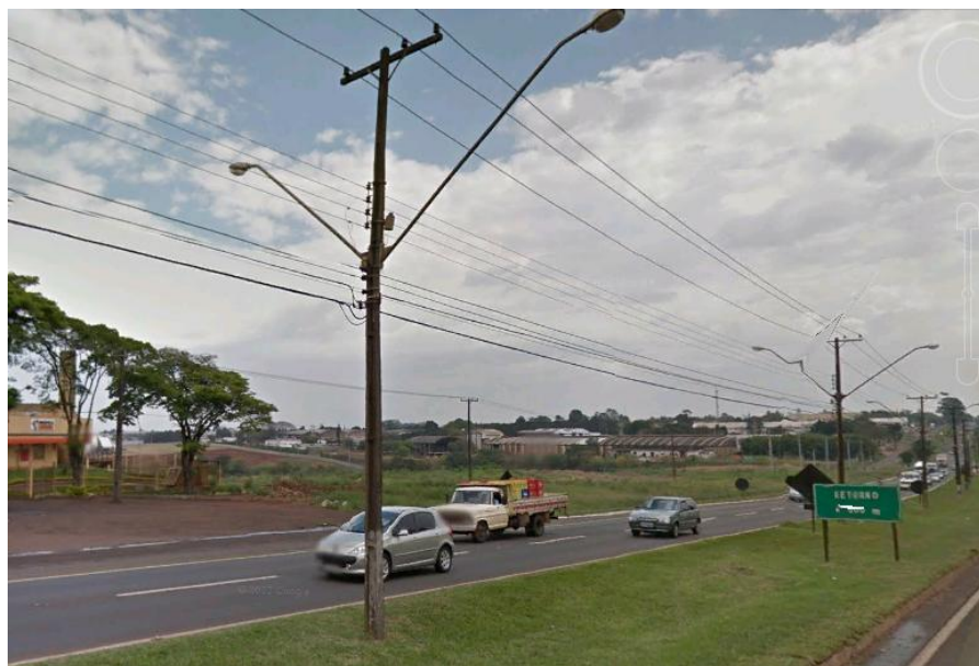
Figura 22: Vista das instalações da iluminação pública na Avenida Tiradentes.
