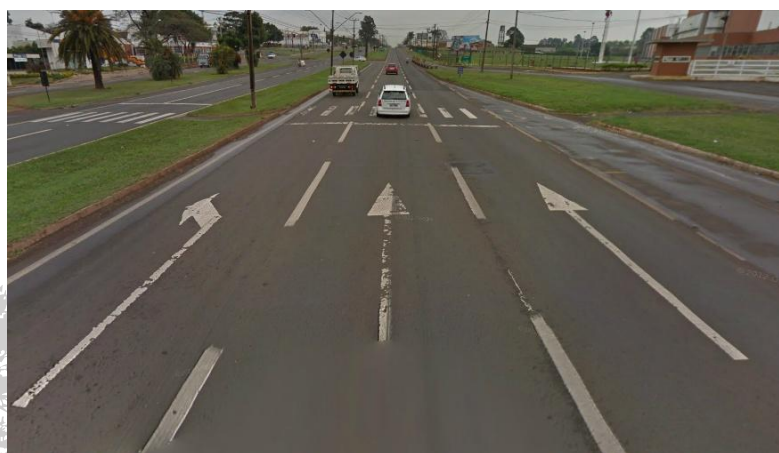
Figura 31: Vista da Avenida Tiradentes (BR 369) e sua sinalização horizontal. Fonte: Google Street View (2012).
