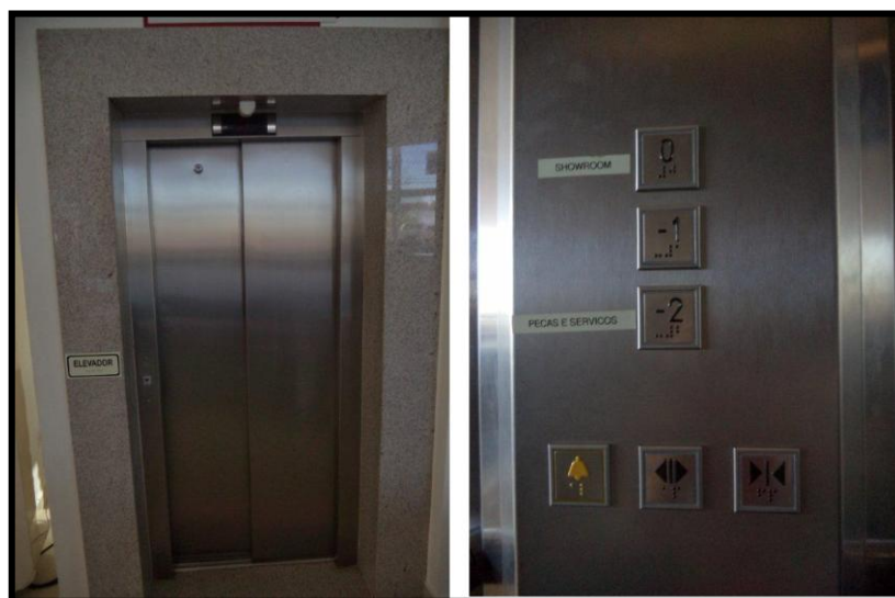
Figura 10: Elevador para facilitar a locomoção entre os pisos.
