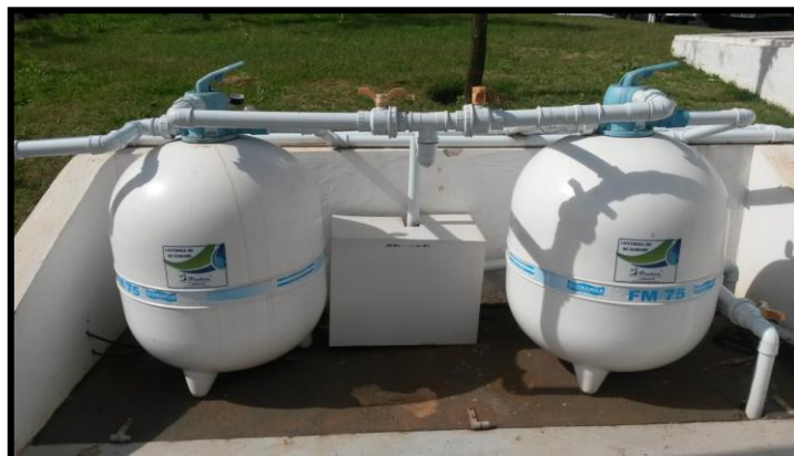
Figura 13: Tratamento do efluente líquido (lavador de veículos).
