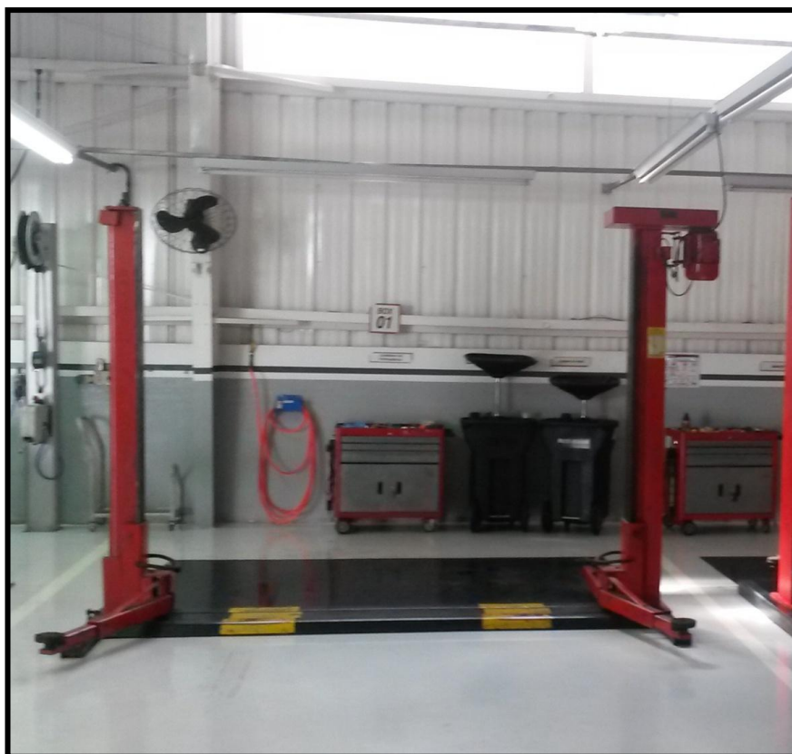
Figura 06: Oficina com devidos equipamentos para coleta de óleo.
