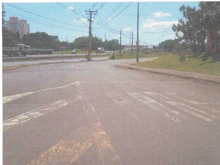
Figura 10: Sinalização de preferencial desgastada. Fonte: Master Ambiental, 2013.
