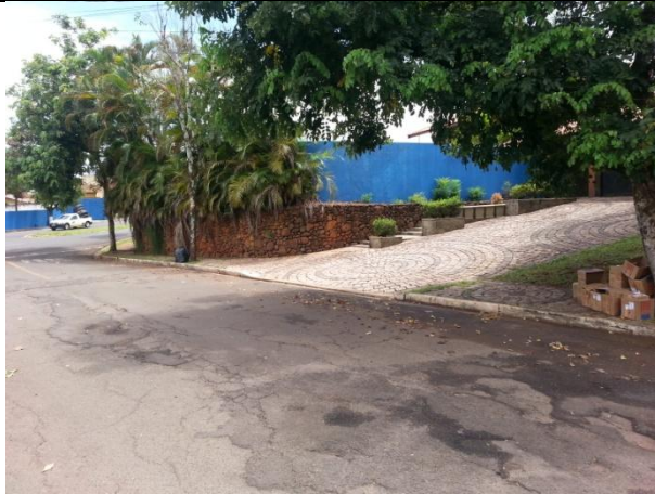
Figura 16 Rua Gastão Madeira com pavimentação mal conservada. Fonte: Master Ambiental.
