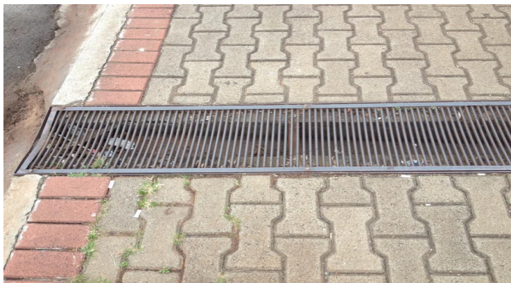
Figura 7 – Boca de lobo frente ao empreendimento. 12/09/2016. Fonte: Vítor Ricci
