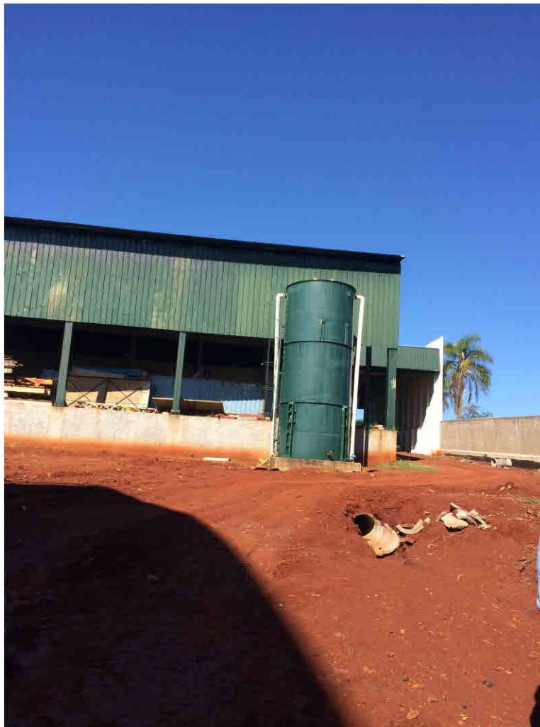
Foto n. 04: Reservatório - águas pluviais.
