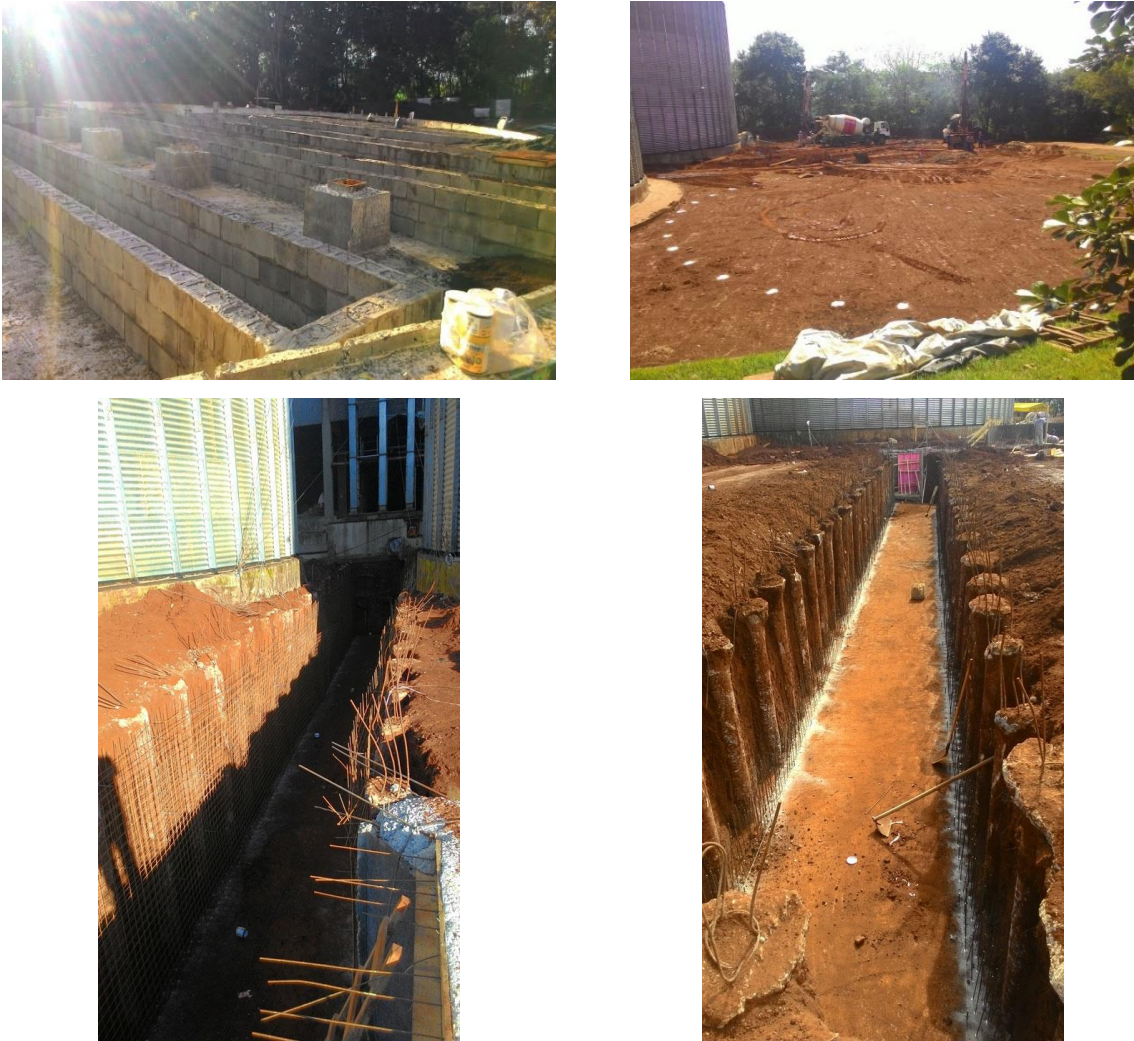
Figura 35. Execução dos serviços de construção civil para a ampliação das estruturas da unidade Serrinha.
