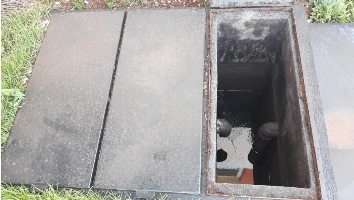
Figura 9 – Sistema de células coalescentes separador de efluente óleo e água
