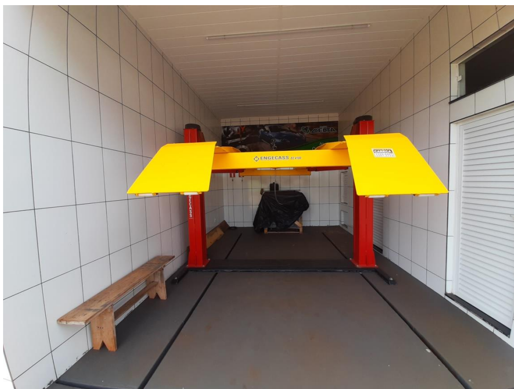
9.a – Canaletas de contenção de lavagem do piso da troca de óleo
