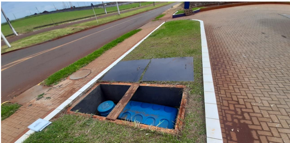
9.c – Caixa separadora de água e óleo instalada no empreendimento
