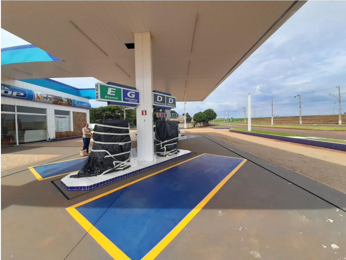
9.b – Canaletas de contenção de lavagem do piso da área de abastecimento
