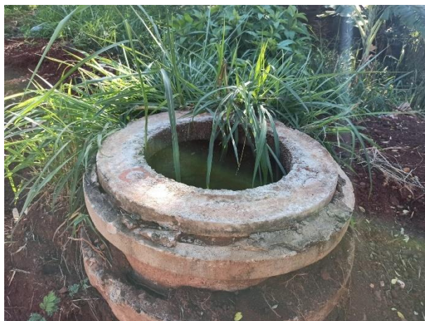
Figura 22: Inspeção galeria pluvial sem tampa, alto risco de acidente. Fonte: Gustavo da Silva, 2021
