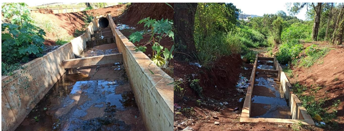
Figura 21: Tubulação de descarga pluvial Fonte: Gustavo da Silva, 2021
