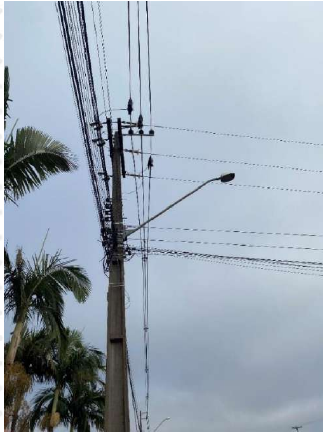
Figura 27: Rede de iluminação pública em frente a ADA. Fonte: Brasil Ambiental, 2021.
