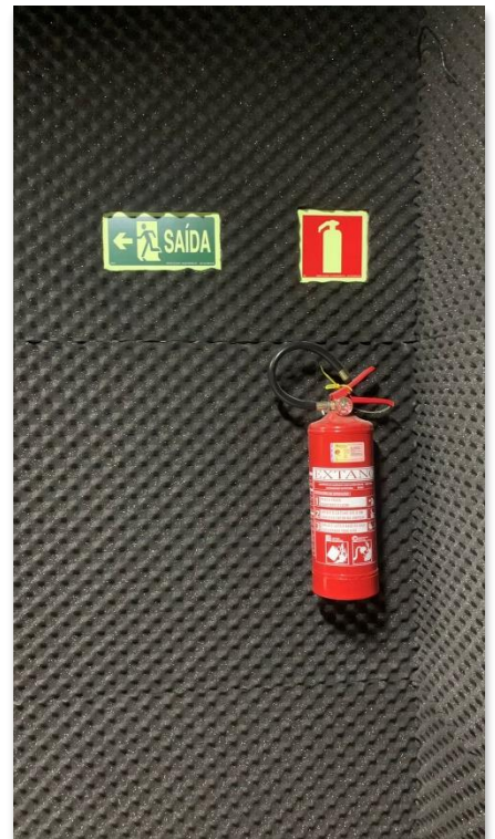
Figura 25 – Prevenção de incêndio.
