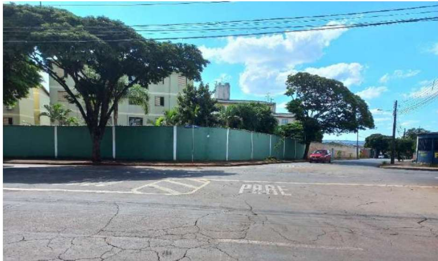
Figura 139: Sinalização horizontal desgastada no cruzamento entre a Avenidas das Laranjeiras e Rua Abricó. Fonte: Master Ambiental, 2022.
