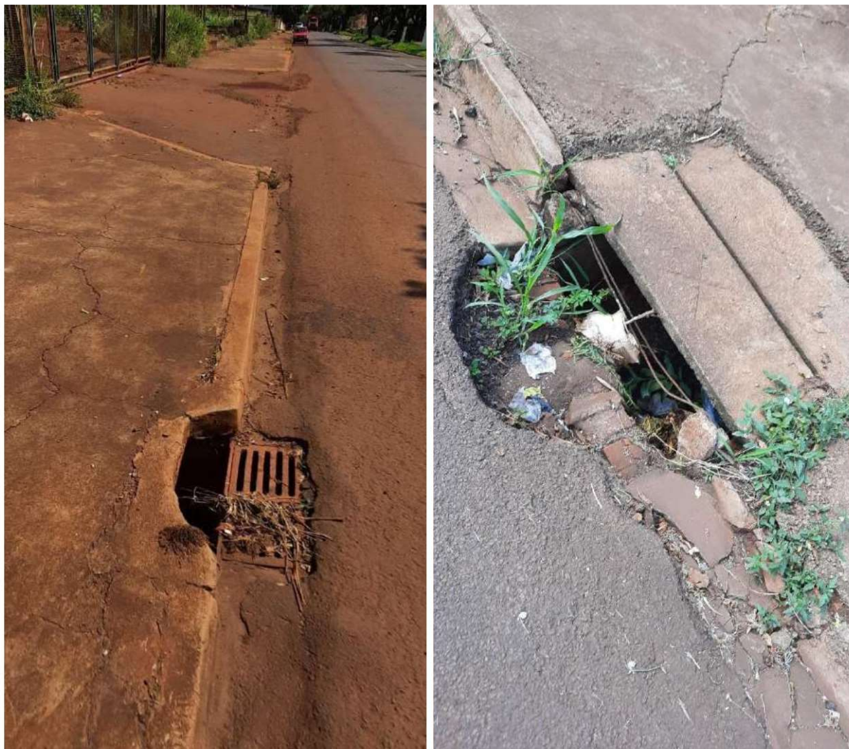
Figura 57: Bocas de lobo próximas ao empreendimento (Av. das Laranjeiras). Fonte: Master Ambiental, 2022.
