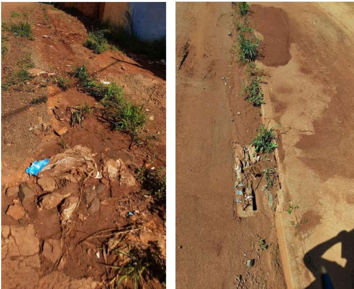
Figura 58: Vala de drenagem (R. Abricó) e boca de lobo obstruída (Av. das Laranjeiras). Fonte: Master Ambiental, 2022.
