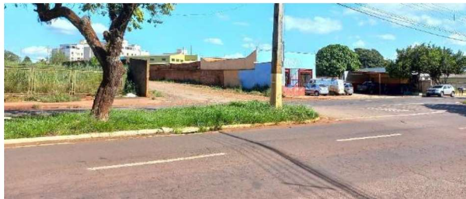
Figura 140: Ausência de sinalização vertical na Avenidas das Laranjeiras. Fonte: Master Ambiental, 2022.
