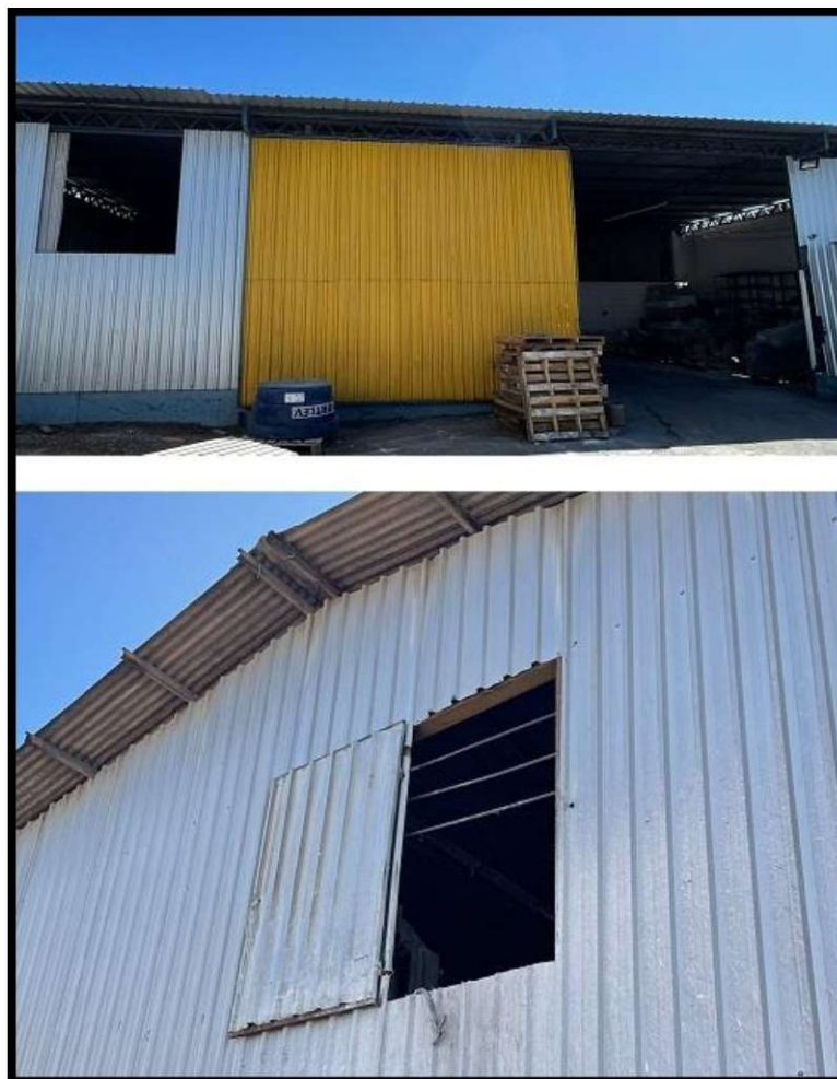
Figura 16: Entrada e saída de ventilação
