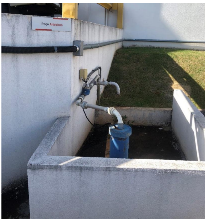
Figura 19: Poço artesiano. Fonte: Master Ambiental.
