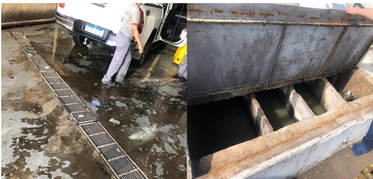
Figura 42: Lavagem de Veículos e Caixa Separadora de Óleo. Fonte: Master Ambiental.
