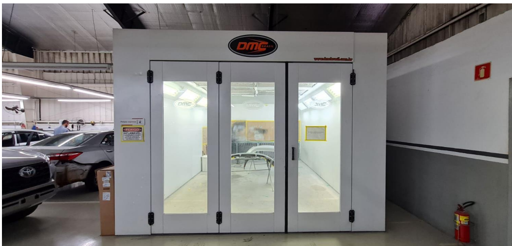
Figura 12: Cabine de pintura no interior do empreendimento. Fonte: Toyopar.
