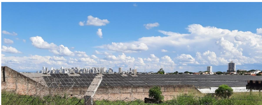
Figura 41: Placas fotovoltaicas. Fonte: Master Ambiental.
