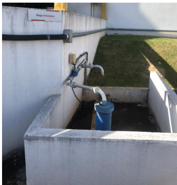
Figura 40: Poço Artesiano no empreendimento. Fonte: Master Ambiental.
