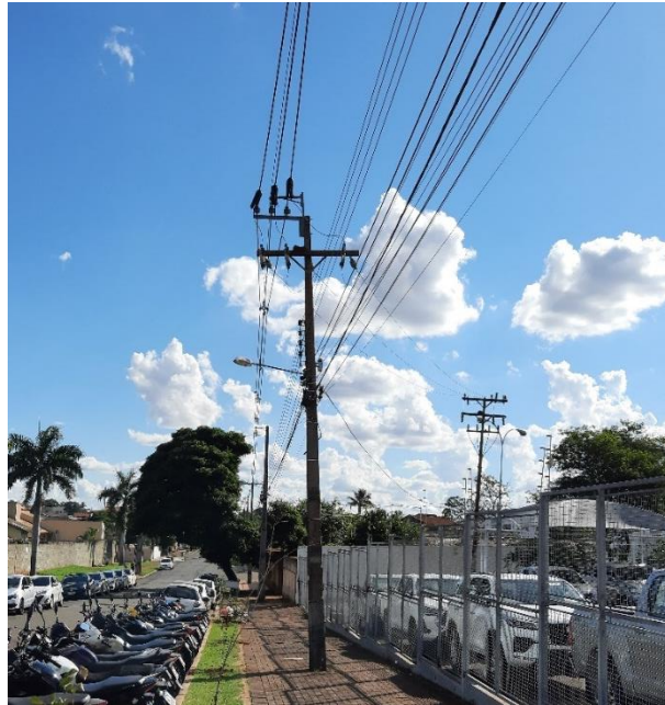
Figura 47: Iluminação pública na calçada do empreendimento. Fonte: Master Ambiental.
