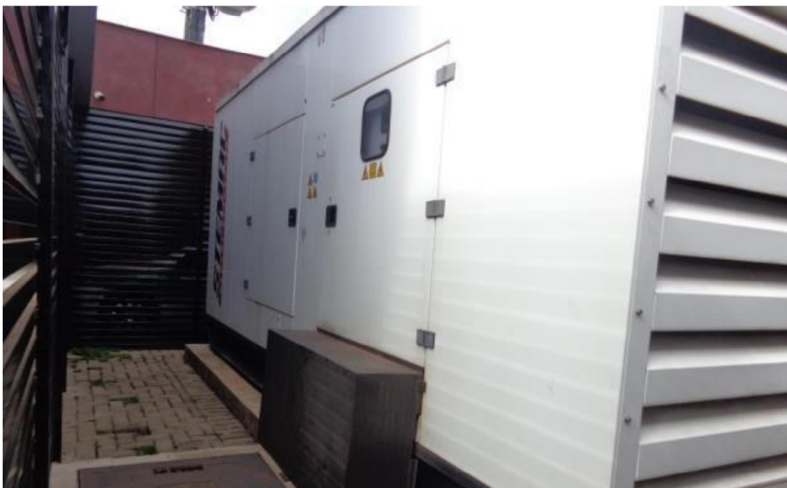
Figura 18: Gerador de Energia no lote. Fonte: Master Ambiental, 2019.
