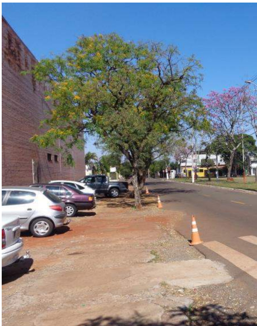
Figura 94: Passeio na Rua Bauru apresentando pavimentação descontínua, ausência de sinalização tátil e faixa de serviço. Fonte: Master Ambiental, 2019.
