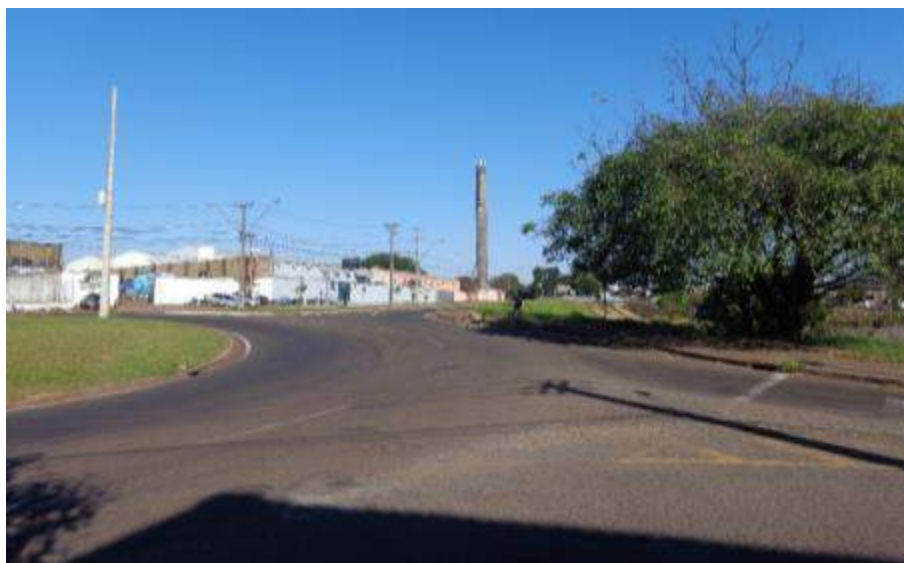
Figura 78: Condição da sinalização viária na rotatória da Avenida Abélio Benatti com a Avenida Universo. Fonte: Master Ambiental, 2019.
