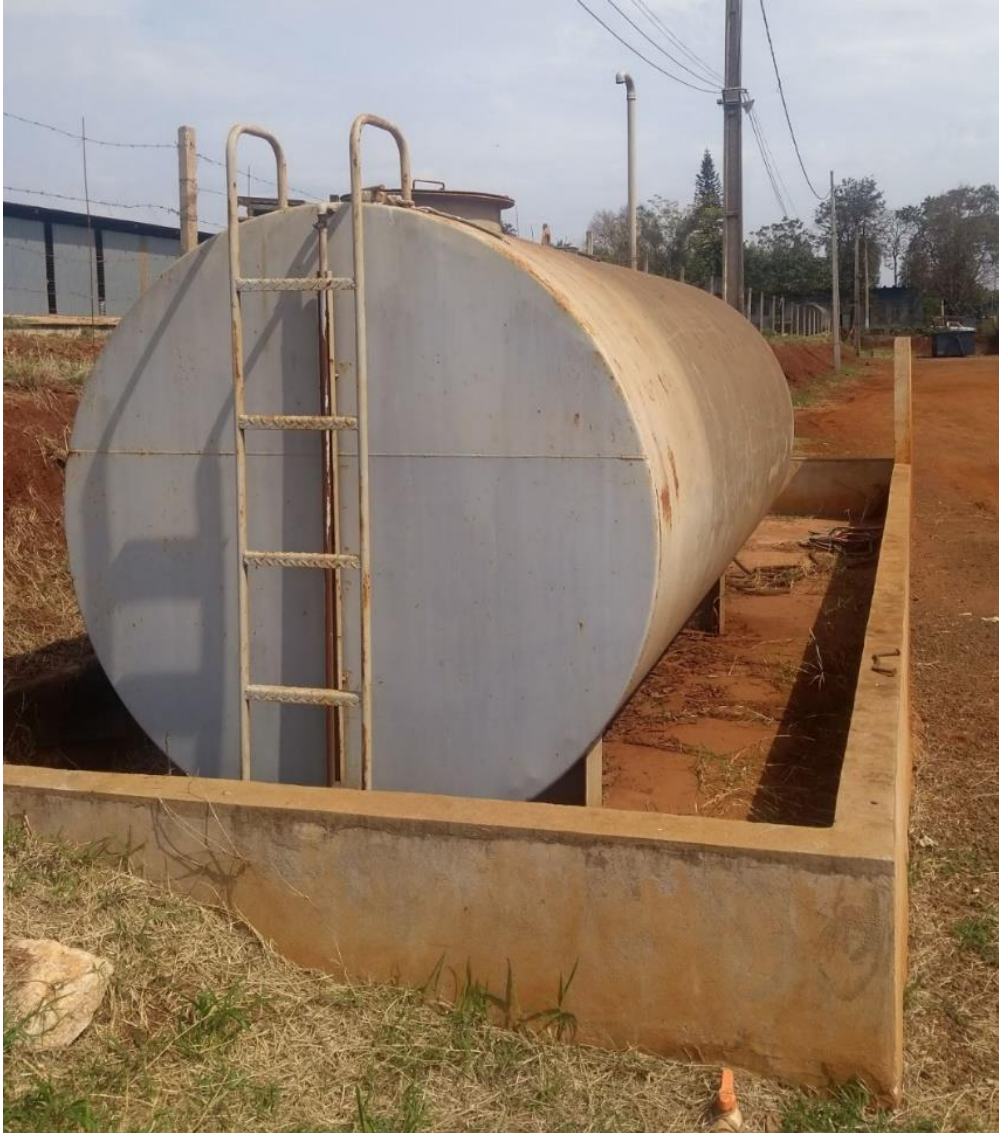
Imagem 12 – Visão do exemplar de tanque de armazenamento de efluentes + bacia de contenção
