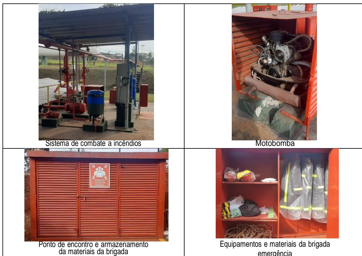
Quadro 10. Sistema de combate a incêndios.
