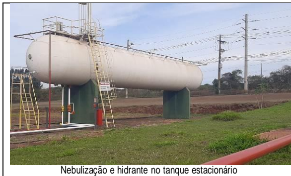
Nebulização e hidrante no tanque estacionário
