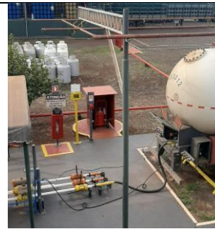
Nebulização no ponto de transferência, alarme e extintores
