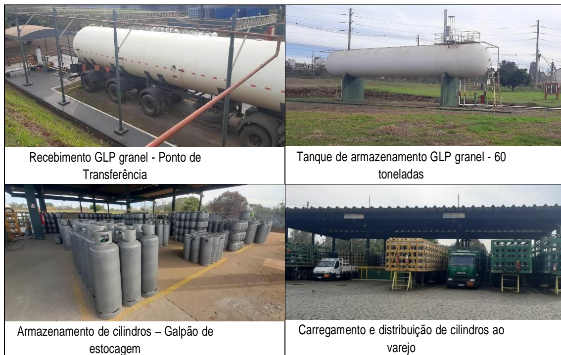
Quadro 5. Recebimento e armazenagem de GLP.
