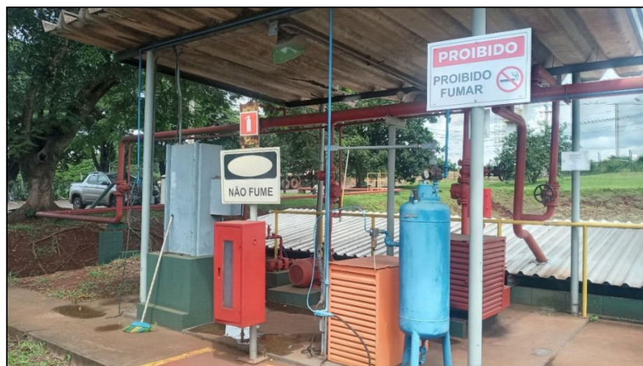
Figura 64. Poço artesiano do empreendimento. Fonte: LL Ambiental, 2023.
