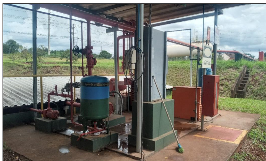
Figura 65. Poço artesiano do empreendimento. Fonte: LL Ambiental, 2023.
