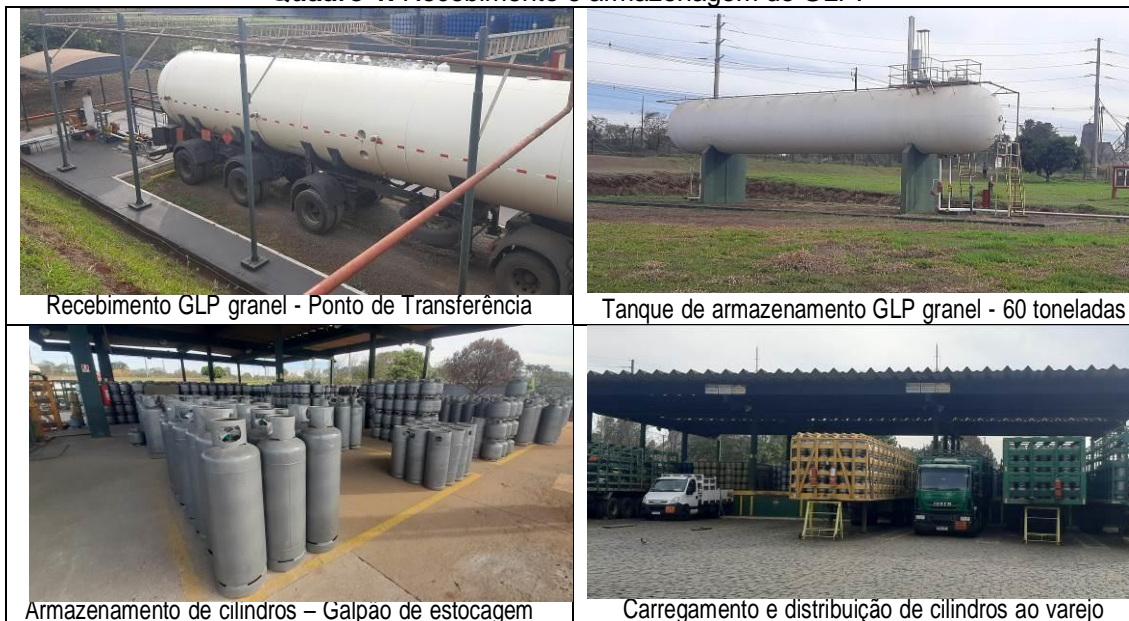
Quadro 1. Recebimento e armazenagem de GLP.
