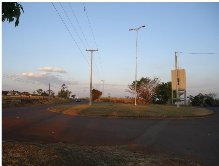
Figura 32: Vista das instalações da iluminação pública na Avenida Guilherme de Almeida.
