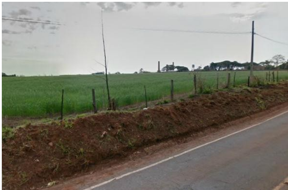
Figura 35: Detalhe das instalações elétricas nos limites do empreendimento.
