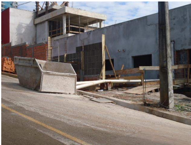
Figura 44: Situação do empreendimento em obra. Pavimentação, Rua Alberto Maurício Barroso Jr. Fonte: Master Ambiental, 2016.
