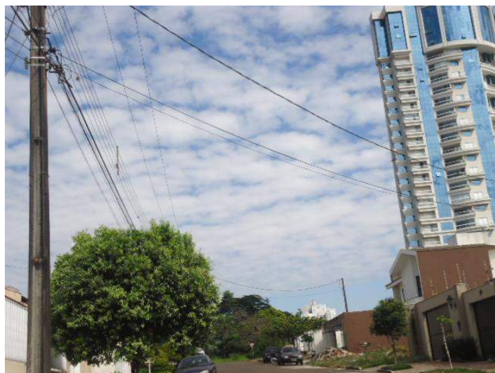
Figura 64: Conflito entre a fiação elétrica e a arborização da Rua Marcondes de Oliveira. Fonte: Master Ambiental, 2016.
