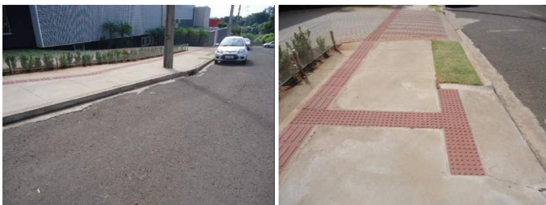
Figura 63: Passeio em condições adequadas. Fonte: Master Ambiental, 2016.
