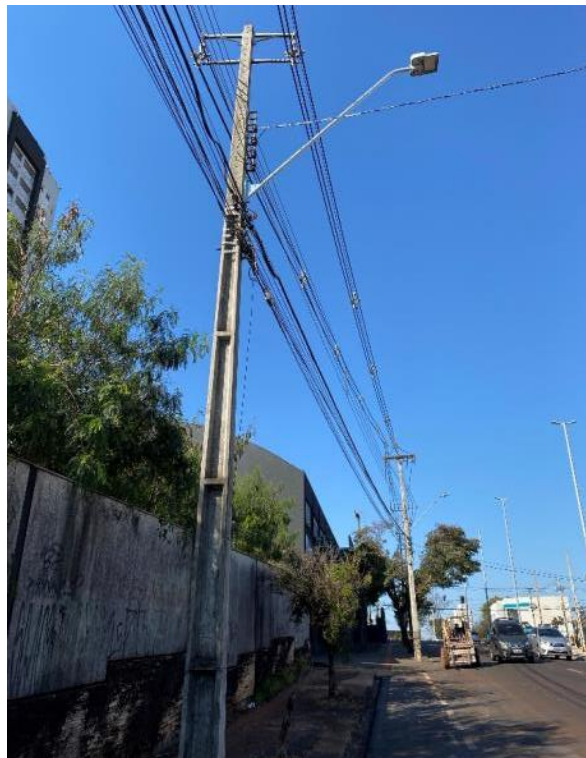
Figura 52: Poste de iluminação em frente ao empreendimento. Fonte: Master Ambiental, 2021.
