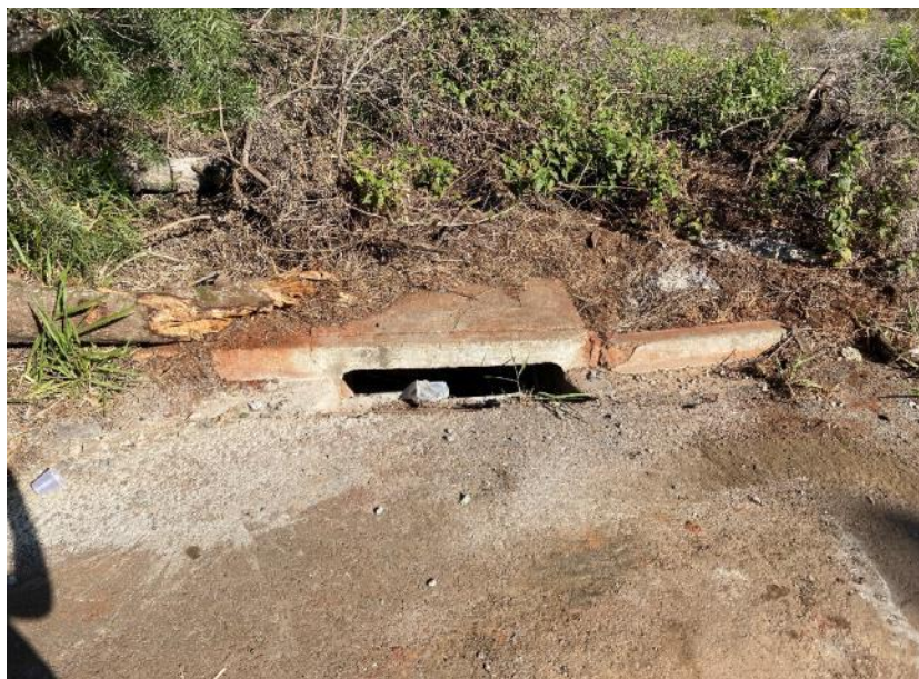
Figura 57: Bocas de lobo no terreno do empreendimento. Fonte: Master Ambiental, 2021.
