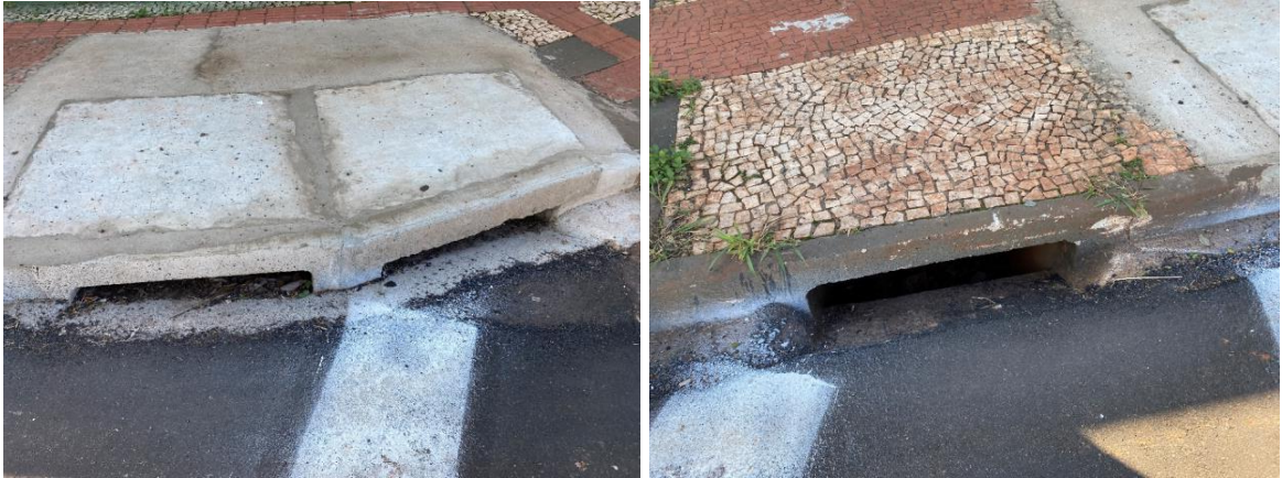
Figura 55: Bocas de lobo próximo ao empreendimento (R. Prefeito Faria Lima). Fonte: Master Ambiental, 2021.
