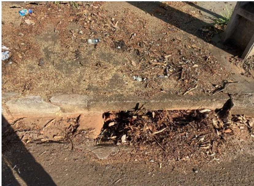
Figura 56: Bocas de lobo próximo ao empreendimento (R. Kioto Okwat). Fonte: Master Ambiental, 2021.
