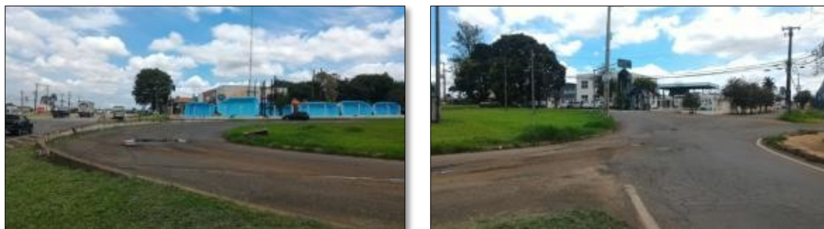
Figura 74: Pavimentação precária na rotatória que dá acesso à Av. Tiradentes próximo à interseção com a Av. Jockey Club. Fonte: Master Ambiental (2018).
