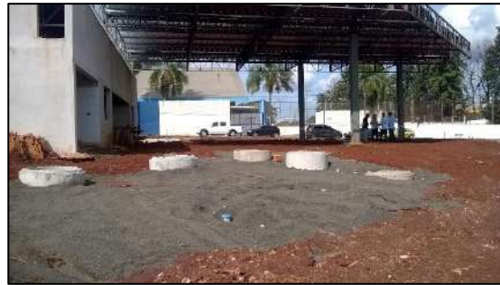
Figura 2: Área de armazenamento dos tanques.
