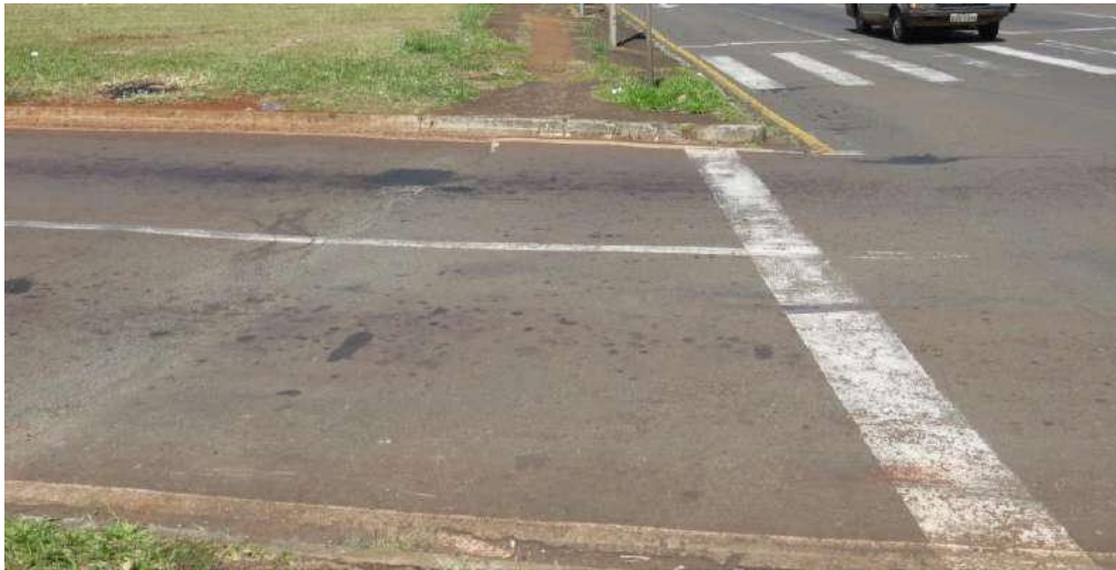
Figura 60: Travessia de pedestre sem sinalização e acessibilidade – Av. Winston Churchil x Av. Brasília
