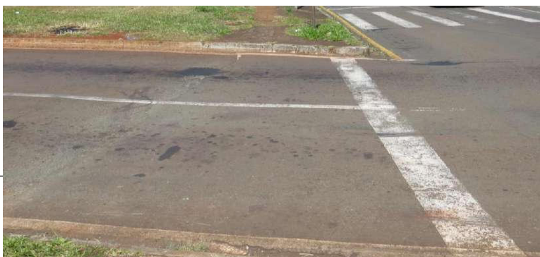
Figura 50: Sinalização Horizontal desgastada – Av. Winston Churchil x Av. Rio Branco
