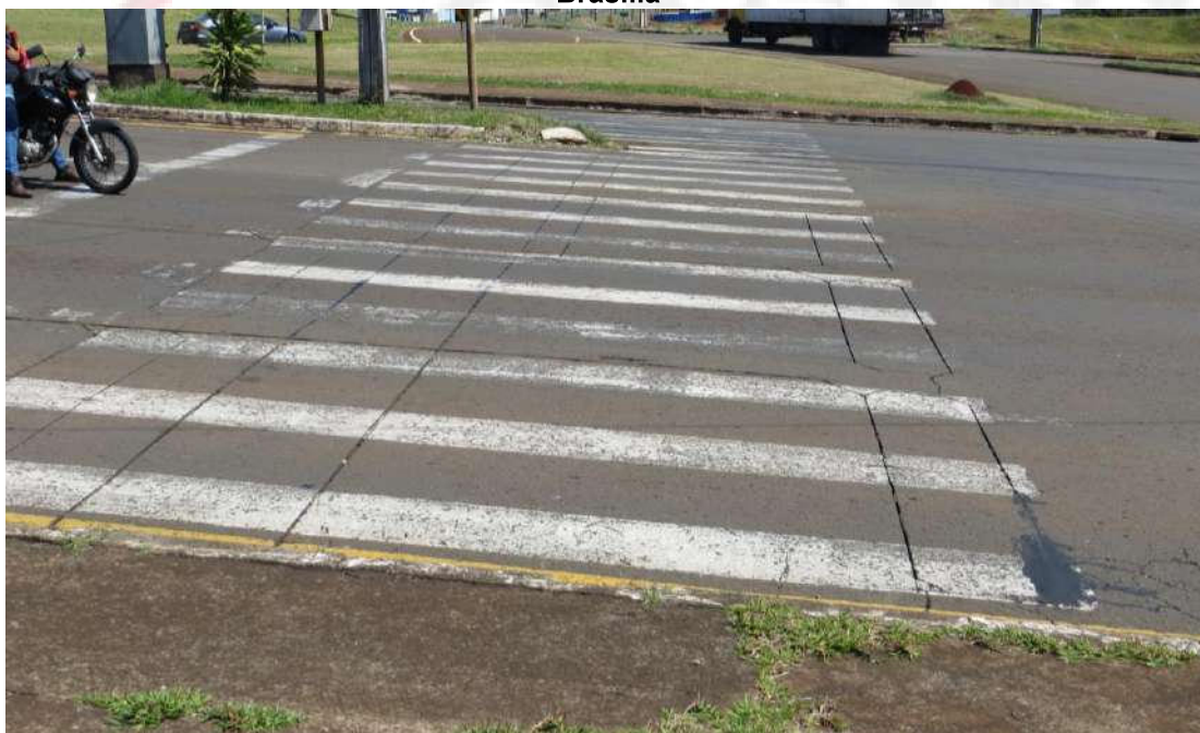
Figura 59: Travessia de pedestre sem acessibilidade – Av. Winston Churchill x Av. Brasília
