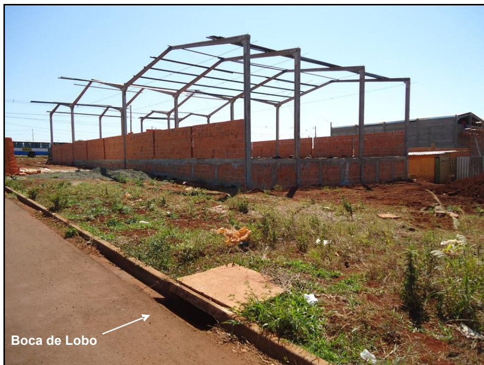
Foto 4 – Vista do empreendimento com atenção à boca de lobo
