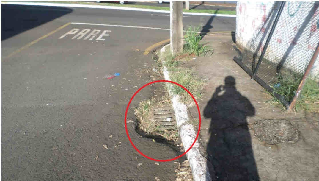
Figura 16: Galeria pluvial na Avenida Amintas de Barros com a Avenida Higienópolis. Fonte: Autor, 2017.
