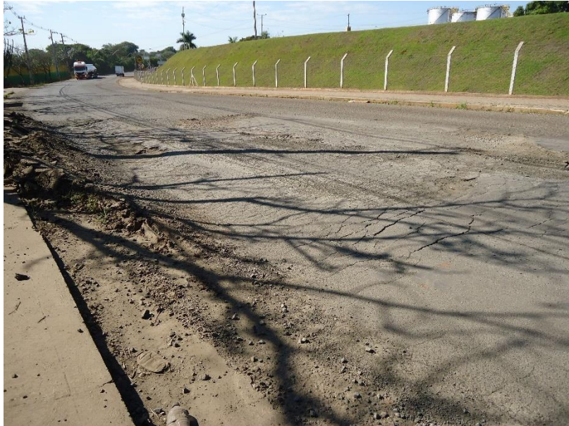
Foto 10 – Pavimentação da via danificada pelo tráfego pesado de veículos
