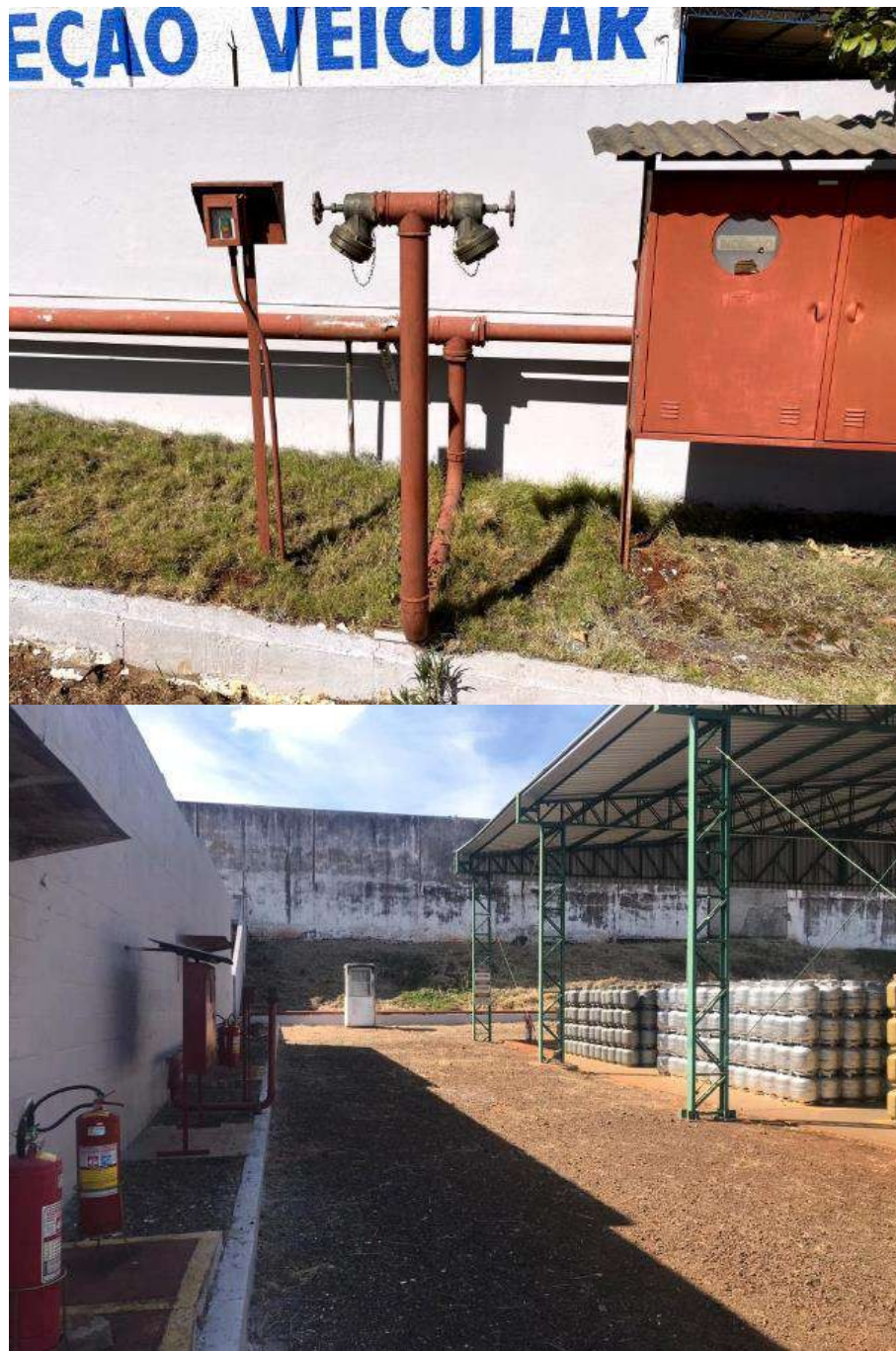
Figura 11: Mangueiras de incêndio e extintores próximos ao local de armazenamento de gás. Fonte: Master Ambiental, 2021.
