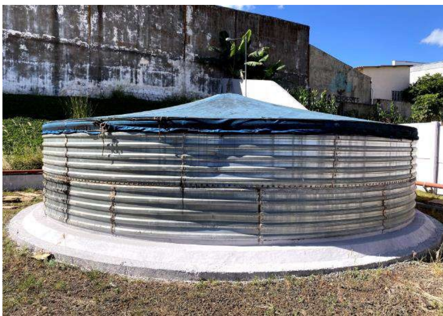
Figura 13.: Reservatório de água a ser utilizado em caso de incêndio. Fonte: Master Ambiental, 2021.
