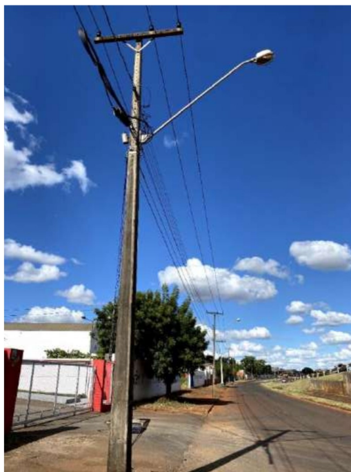
Figura 45: Poste de iluminação em frente ao empreendimento. Fonte: Master Ambiental, 2021.
