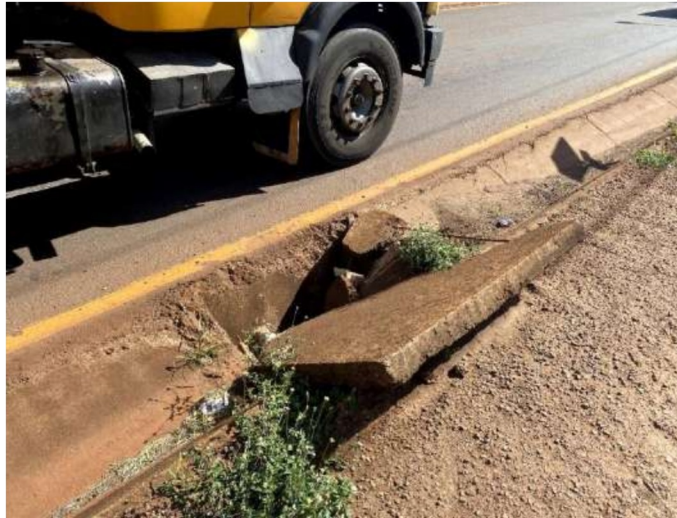
Figura 48: Boca de lobo próximo ao empreendimento (Marginal PR-445). Fonte: Master Ambiental, 2021.
