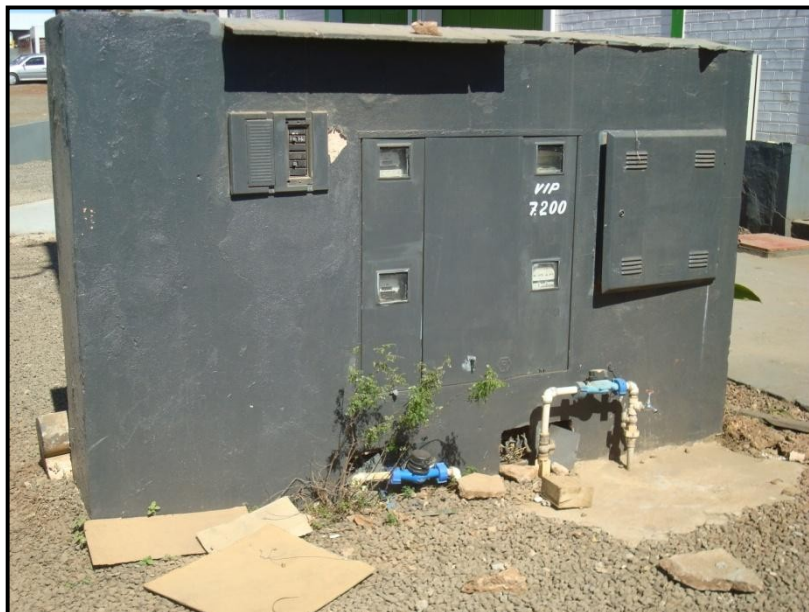
Figura 30 – Local de Distribuição de Água para os barracões da Giro Londrina.
