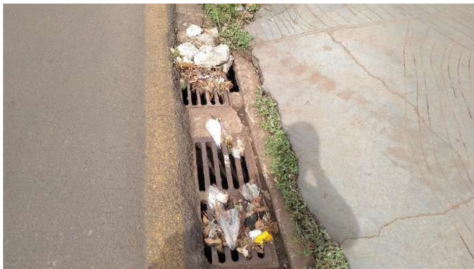
Figura 62: Boca de lobo - Rua Fernando de Noronha com Av. Arcebispo Dom Geraldo Fernandes. Fonte: Master Ambiental (2022).
