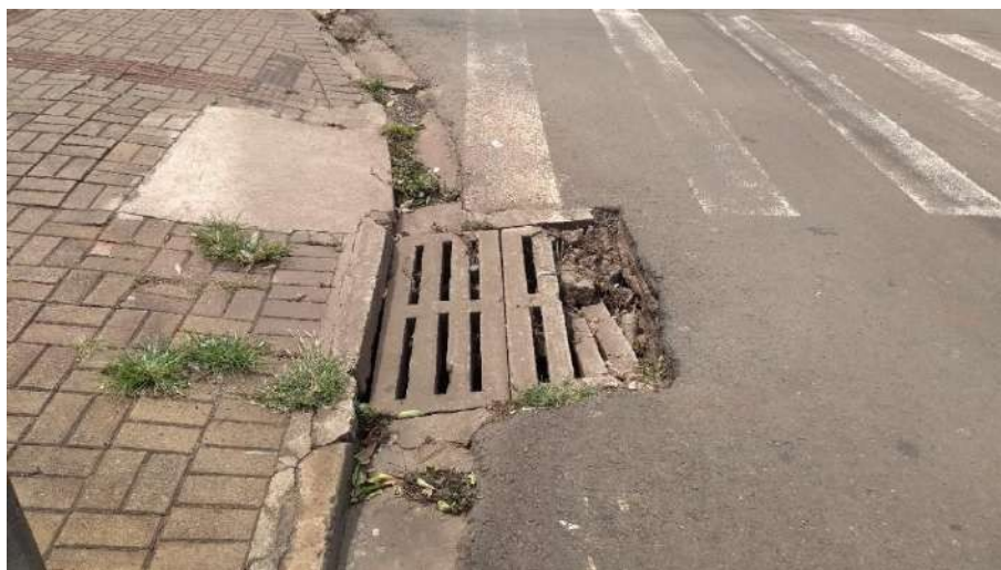
Figura 59: Boca de lobo - Rua Prefeito Hugo Cabral com Rua Fernando de Noronha. Fonte: Master Ambiental (2022).
