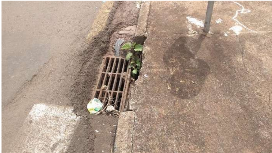
Figura 60: Boca de lobo - Rua Fernando de Noronha com Rua Prefeito Hugo Cabral. Fonte: Master Ambiental (2022).
