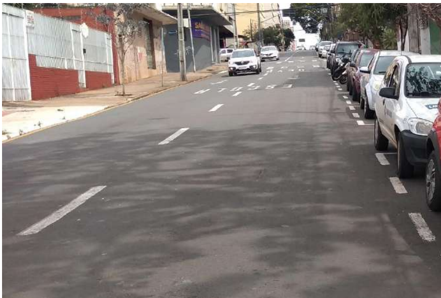
Figura 128: Situação da pavimentação no cruzamento da Rua Prefeito Hugo Cabral, via de acesso ao empreendimento. Fonte: Master Ambiental, 2022.
