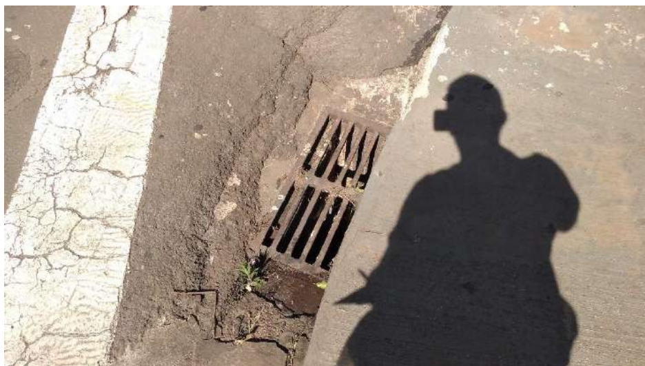
Figura 63: Boca de Lobo - Rua Benjamin Constant com Rua Prefeito Hugo Cabral. Fonte: Master Ambiental (2022).
