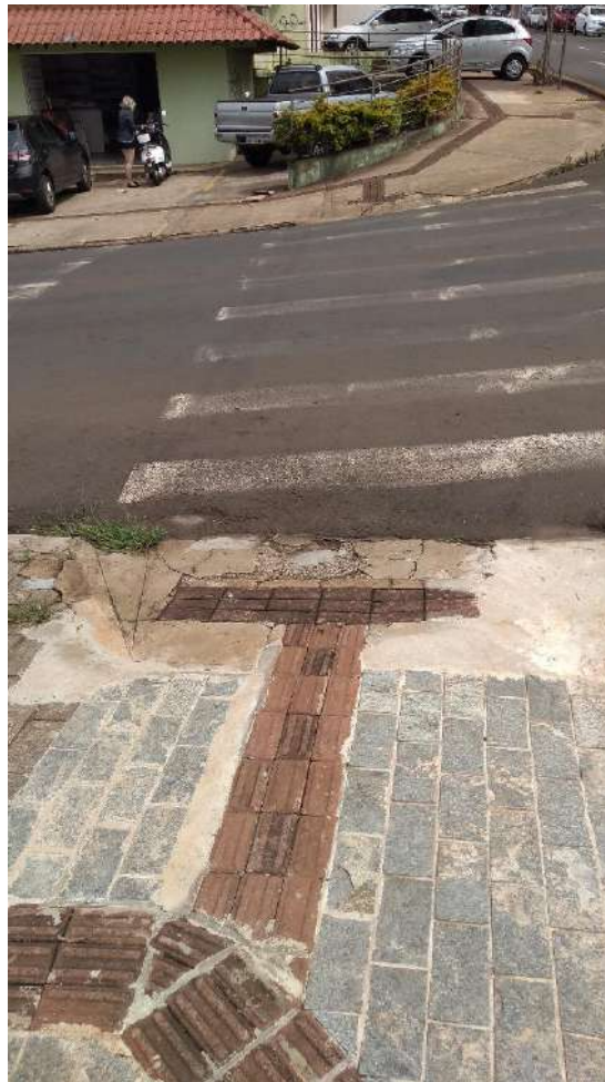
Figura 146: Rampa de acessibilidade no passeio do passeio público do entorno do empreendimento. Fonte: Master Ambiental, 2022.
