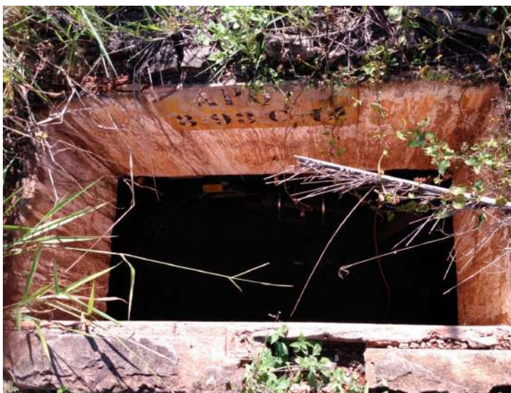
Figura 54: Caixa de passagem subterrânea descoberta, rua Roberto Romanelli.
