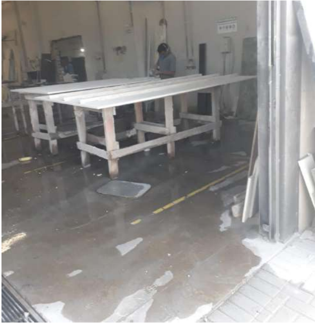
Figura 26: Piso com transbordamento de água da mesa de corte. Fonte: Elaborado pelas autoras, 2023.
