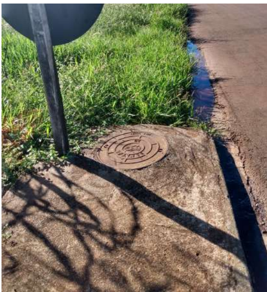
Figura 32: Poço de visita, rua Roberto Romanelli.
