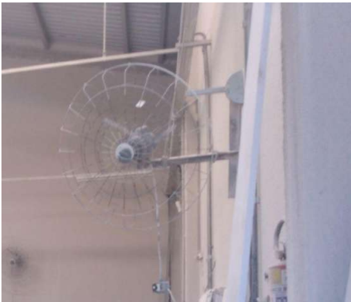
Figura 12: Ventiladores no interior do barracão de produção.
