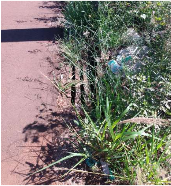
Figura 31: Galeria pluvial da rua Roberto Romanelli, obstruída por vegetação e rejeitos.
