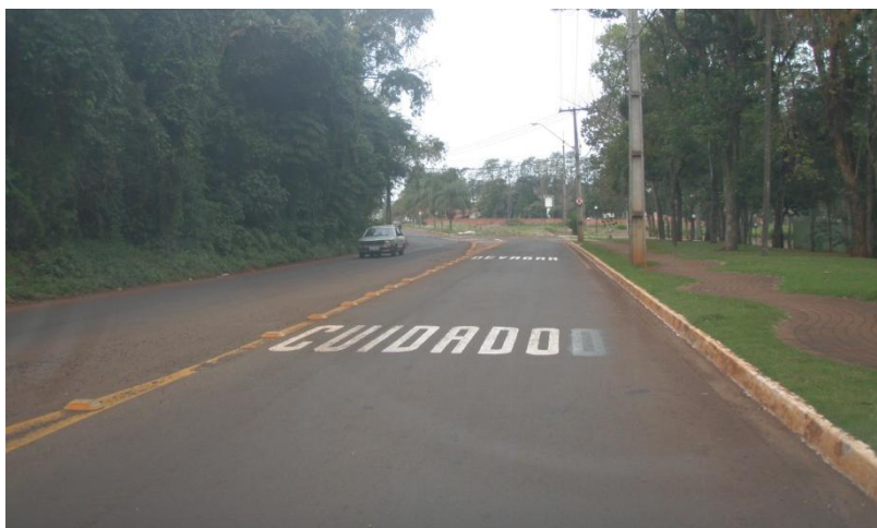
Figura 50: Vista da Avenida Gil de Abreu e Souza e sua sinalização horizontal.
