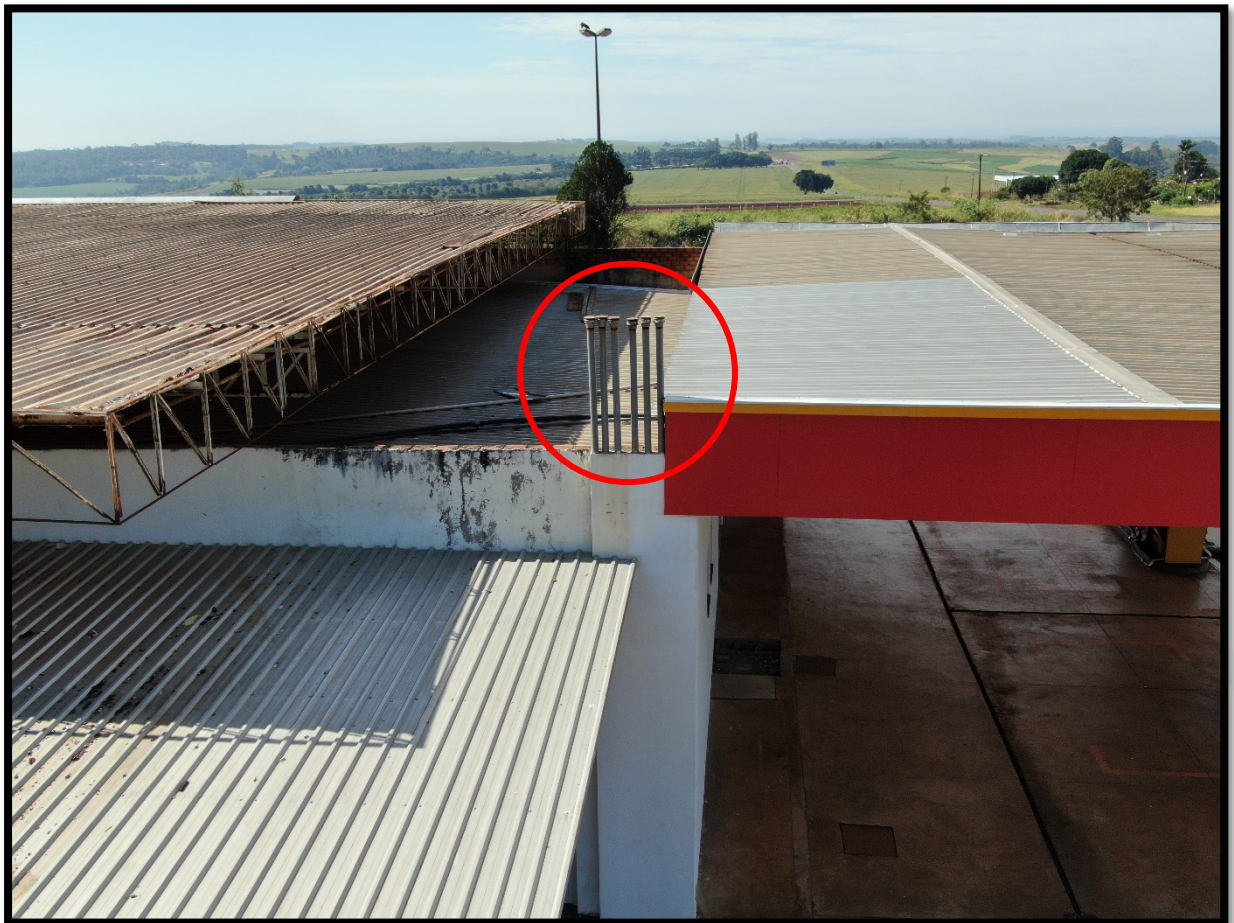
Figura 05 – Respiros dos tanques instalados no local
